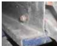
Rostig skruv och oxiderad krok
