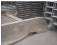
Skada i profil till plattform
