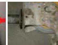
Pręt w złym stanie
