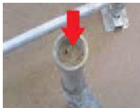
Zanieczyszczenia w czopach
