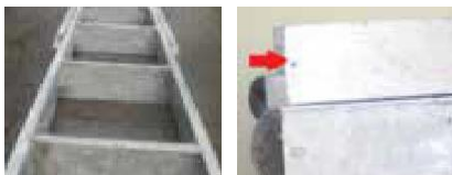
Likaa puolien päällä Puuttuu kiiloja
