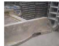
Lavan pinta vaurioitunut
