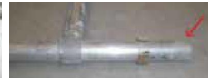
Sivusuojakaiteen kehyksen alaosan kohdalla ei ole holkkia
